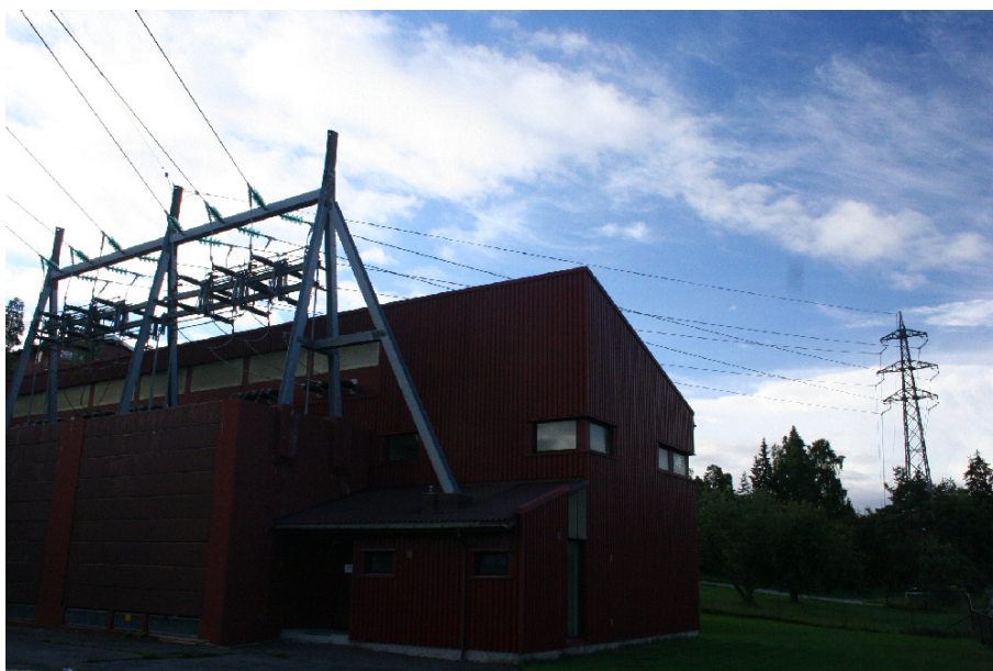
Figur 2: Transformatorstasjon koplet direkte på 45 kV ledning.
